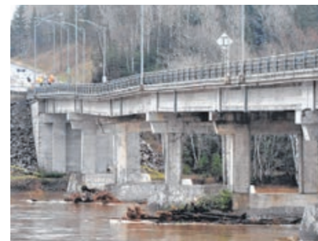
C'est lors des inondations printanières que le pont de la Cascapédia avait été endommagé. (Photo Le Pharillon – Frédéric Durand)
