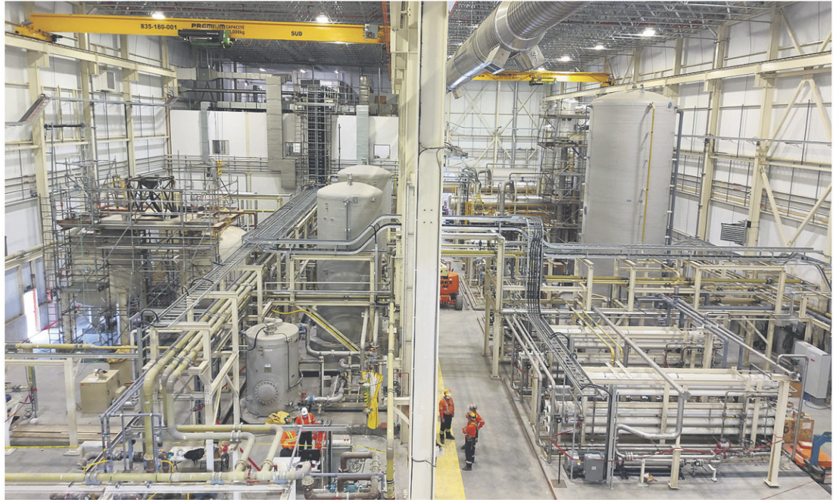
USINE DE TRAITEMENT DES EAUX DE LA MINE NIOBEC, AU SAGUENAY-LAC-SAINT-JEAN
