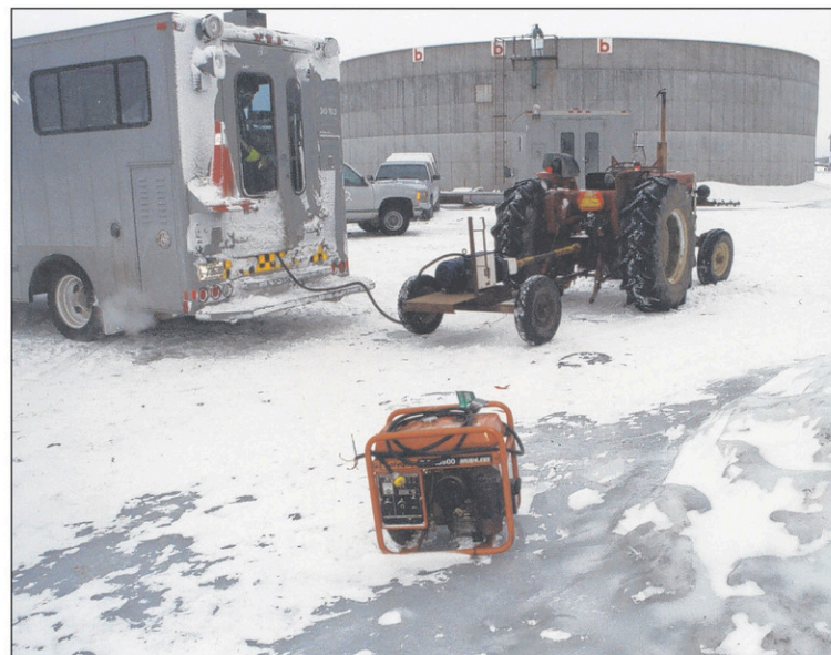
Pas moins de 500 génératrices provenant du Québec et du Manitoba ont été acheminées au centre de dépannage.
