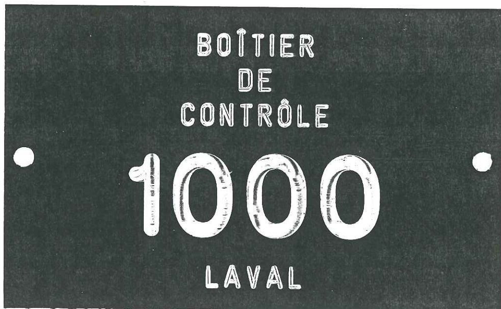
BOÎTE DE CONTRÔLE
