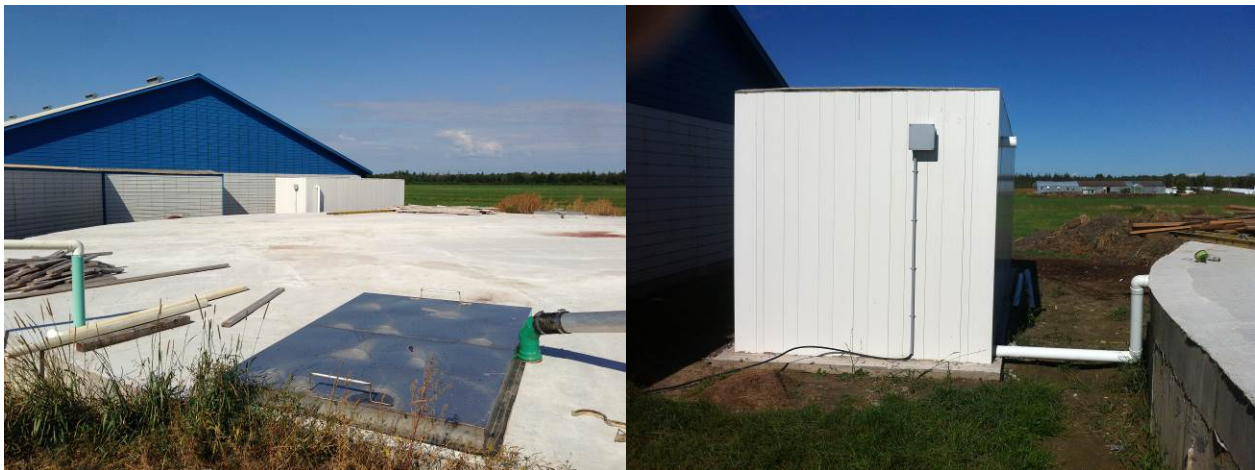
Figure 5 : Biofiltres #1 et #2 conçus par Écosphère et installés à la ferme R & R Fortin (Source : Girard, M. et Belzile, M., 2013)
