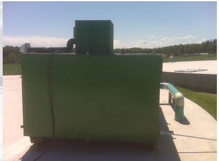
Les Élevages Parent : vue rapprochée du biofiltre monté sur la toiture de béton de la fosse de X m.
