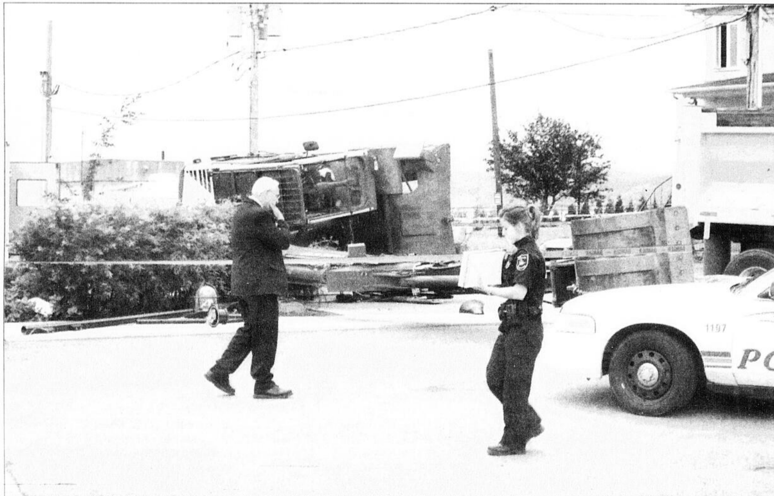
NORMES - Selon certains témoins, les barres stabilisatrices de la pelle mécanique n'étaient pas déployées et aucun périmètre de sécurité n'avait été délimité avant l'accident. Une enquête est en cours pour vérifier si les normes d'utilisation de ce type de machinerie lourde ont été respectées.
