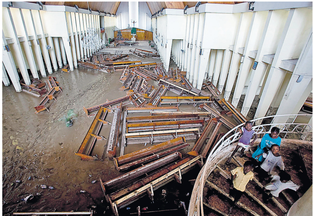
Des inondations ont fait des milliers de sinistrés dans le nord d'Haïti. La cathédrale Saint-Charles-Borromée n'y a pas échappé. Sa nef a été submergée par des torrents de boue. PHOTO MARTIN TREMBLAY, LA PRESSE
