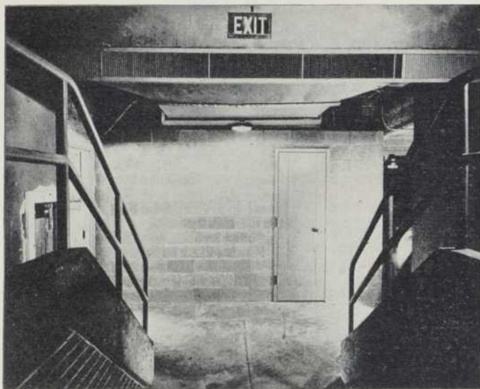
Sortie d'air chaud typique à l'entrée des gradins. Tous les accès aux gradins sont munis de telles sorties, assurant une uniforme répartition de chaleur à travers l'arène.
