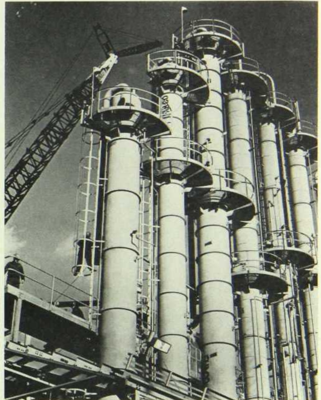
Tours de fractionnement de l'usine chimique de Shell Canada Ltd. à Montréal-Est.
