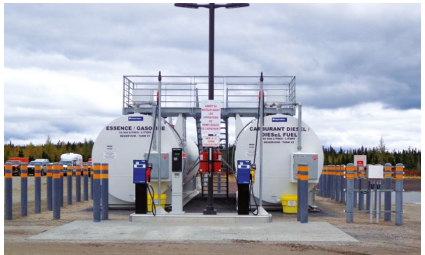
■ Poste Montagnais Hydro-Québec, Sept-Îles
