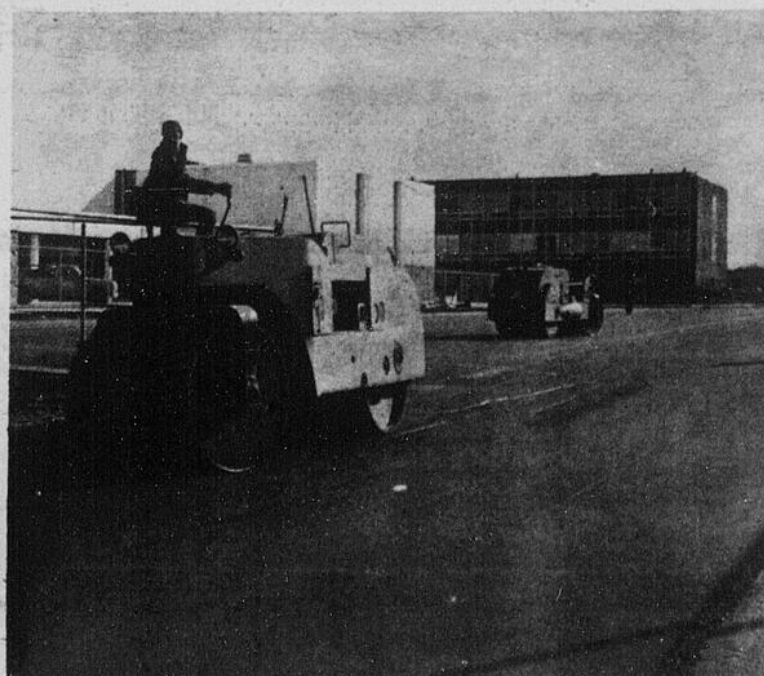
La polyvalente de 1600 places-élèves, construite par la firme Laval Fortin Ltée, est pratiquement terminée. On s'affaire présentement à asphaltier les voies d'accès et le stationnement.
