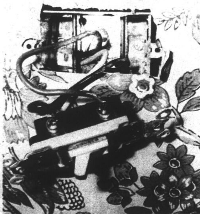
Des connecteurs qui ne sont pas approuvés pour utilisation avec des fils d'aluminium.
