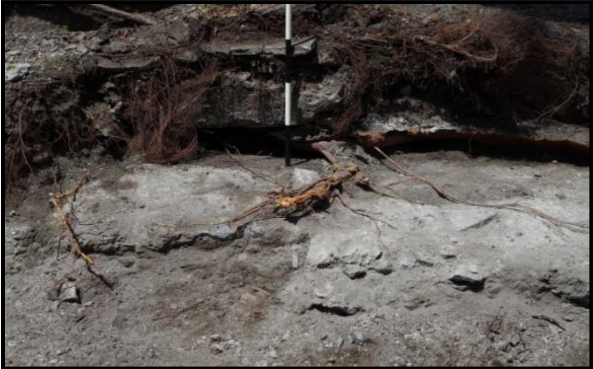
Figure 46. Face sud du vestige de ciment 9A250, montrant l'étendue des dommages causés par les racines de l'orme d'Amérique qui pousse en partie par-dessus le vestige (Photo : S. Noël).
