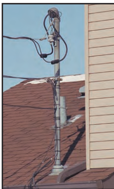
Se tenir à 1 mètre d'une ligne à basse tension de moins de 750 volts.
