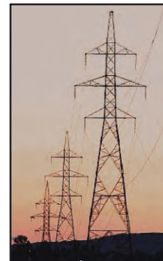
On reconnaît les lignes haute tension par leurs pylônes.
