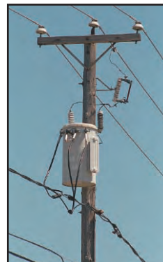
Se tenir à 3 mètres d'une ligne à moyenne tension de 750 à 119 000 volts.
