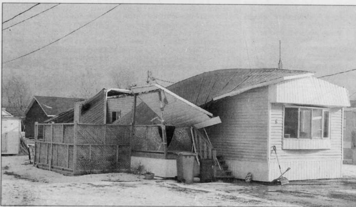
Le toit de la maison mobile de Rémi Jeanson s'est littéralement effondré sous la force du vent.
