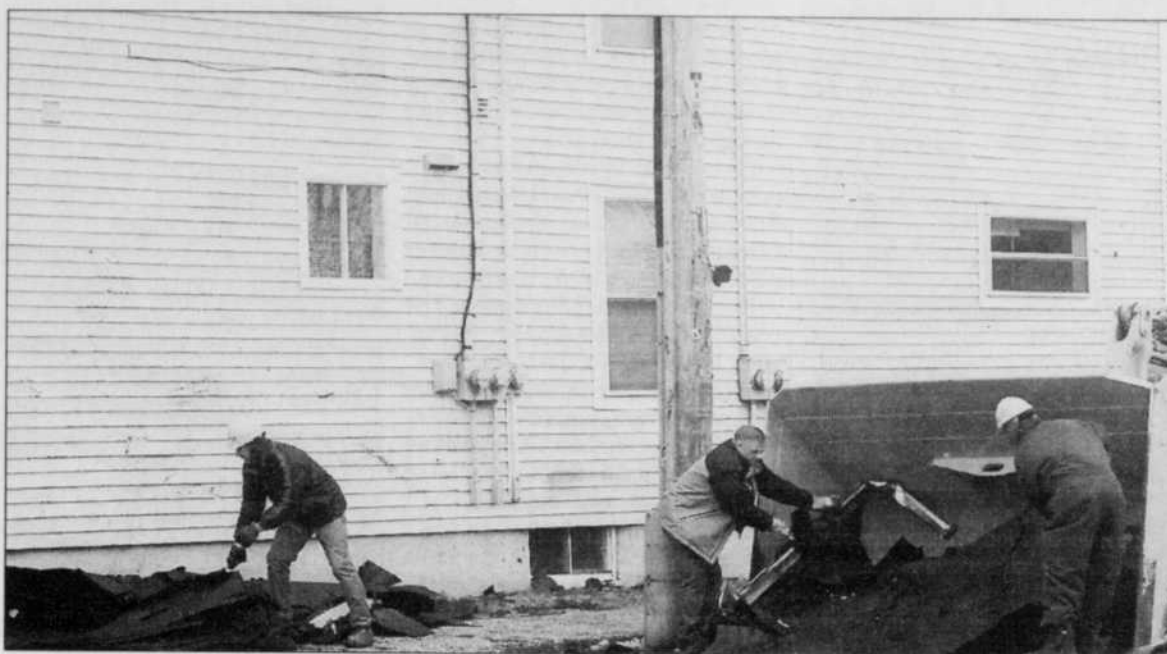
Des employés des Travaux publics s'affairaient à ramasser les débris de toiture tombés d'un immeuble à logements, à proximité de la rue St-Jacques.
