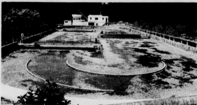
De plus en plus d'industries de Bretagne possèdent maintenant leur propre système d'épuration des eaux, afin d'éviter de polluer les rivières.
