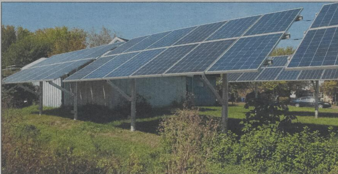
Les 60 panneaux solaires installés sur le terrain d'une résidence de Marieville fournissent 18 000 kW par année.
