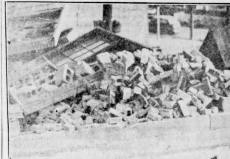
Des dommages considérables ont été enregistrés au cours de la nuit dernière à la Fonderie Legaré, rue Fédéral, alors que l'ouragan a démolé tout un étage de brique, mettant complètement à découvert le département où l'on dessine les patrons. M. Legaré est l'un des plus éprouvés par la tempête de la nuit dernière. Sa maison d'été au Petit Lac Magog a été également fortement endommagée. (Photo La "Tribune")
