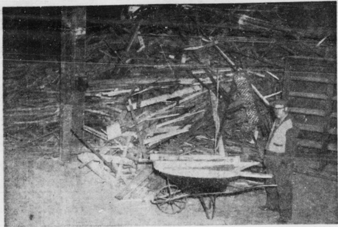
LES TRAVAUX DE TRANSFORMATION se poursuivent à l'Hôtel Viger, devenu la propriété de la ville de Montréal. On a annoncé, hier, à l'hôtel de ville de Montréal, que les bureaux qu'on est en train d'y aménager pour loger une partie du personnel de l'hôtel de ville, ne pourront être occupés avant 1954.
