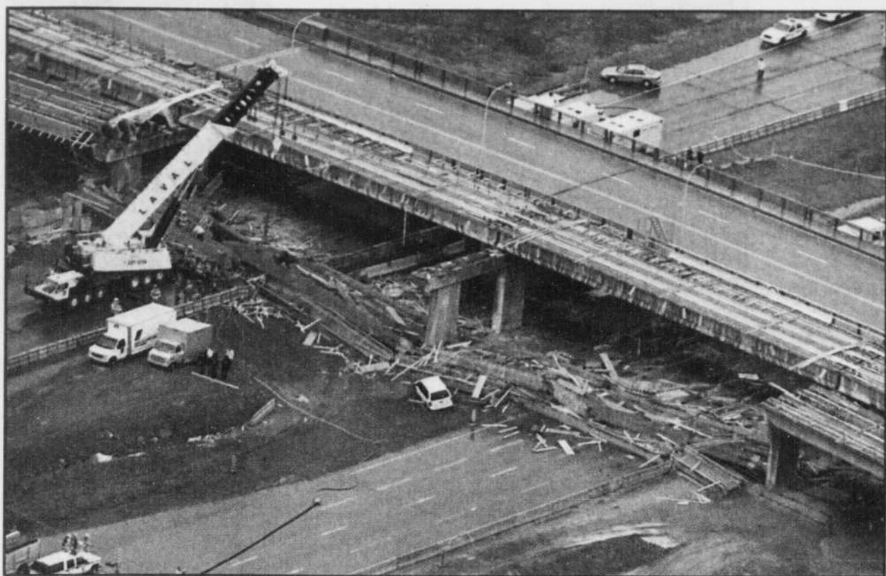
La structure du nouveau viaduc en construction depuis décembre 1999, qui s'étendait sur une longueur de 100 mètres, s'est effondrée sur toute la largeur de l'autoroute.
