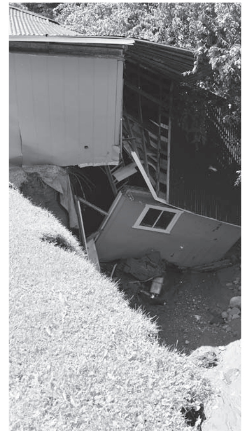
Chemin Sage: Terrain grugé par un ruisseau avec pour résultat une maison proche de la cavité et un garage effondré
