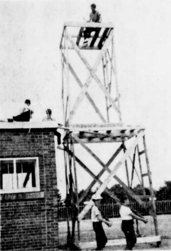
EN CONSTRUCTION. — Les techniciens poursuivent la construction de la rampe de lancement qui doit soutenir l'énorme fusée "Tour du Monde 2", une réalisation des otéjistes du parc Dollard. A remarquer l'éroite surveillance exercée par deux gardes.
