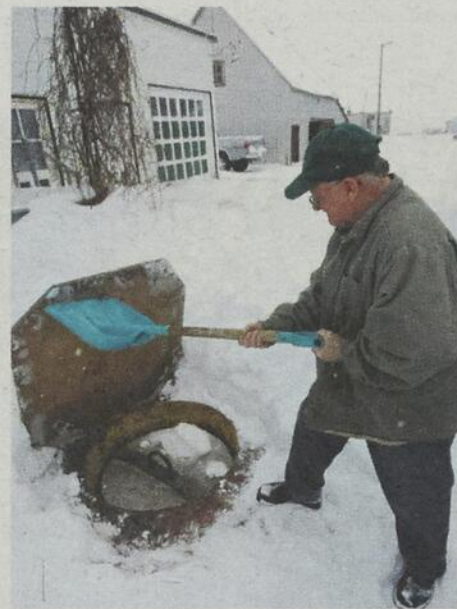
Michel Girouard a installé une fosse septique étanche jugée non conforme. Photo Patrick Roger | Le Courrier ©
