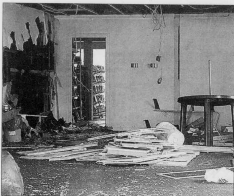
Les dégâts causés hier matin au 849 chemin Shefford à Bromont, s'élèvent à près de 30 000 $, selon les pompiers.
