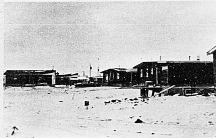
Quelques-unes des 10 maisons en construction au projet Desjardins & Frères au Village Lafontaine.
