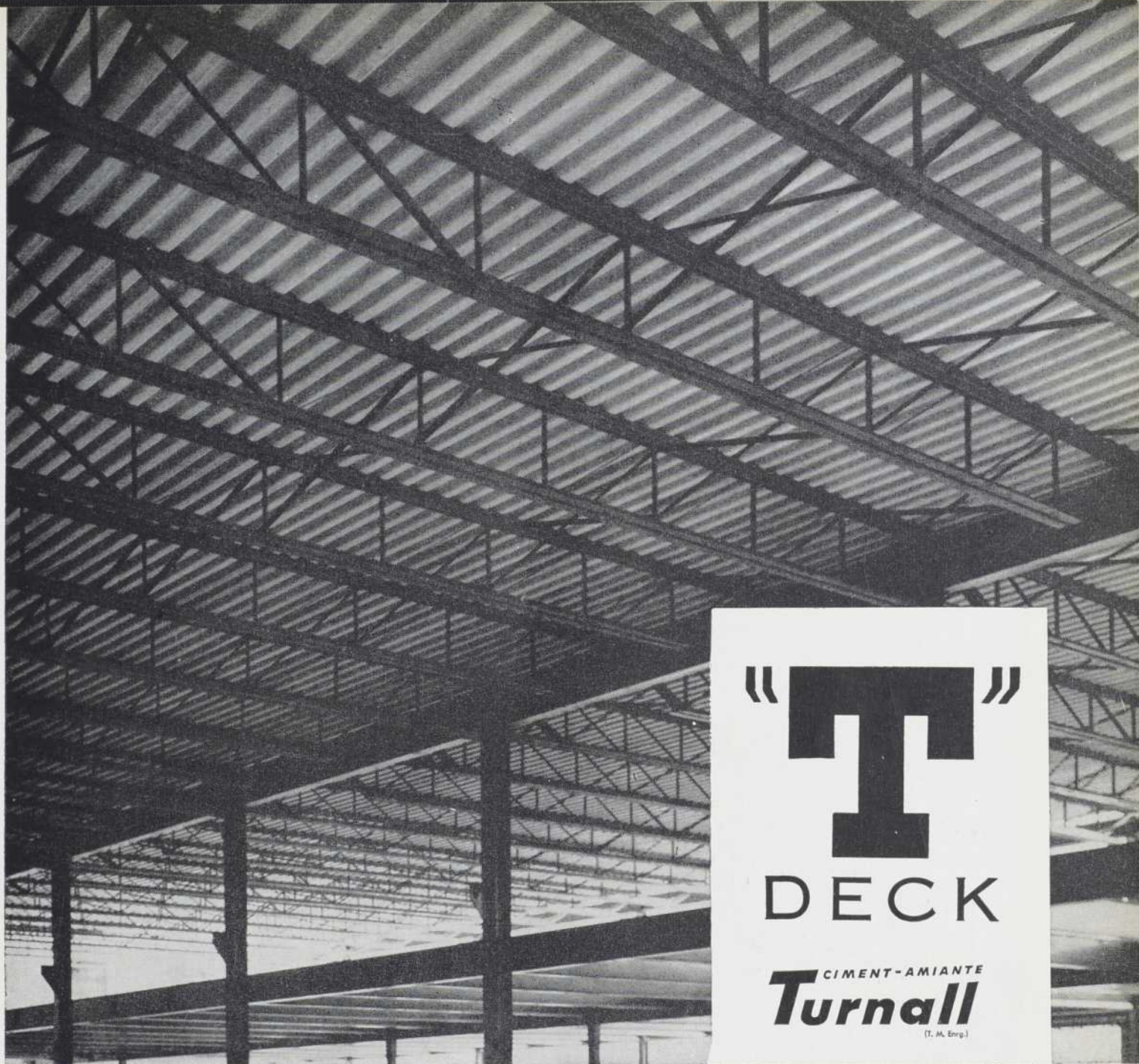
Un nouvel édifice industriel construit avec "T" Deck chez Ayers, Lachute, P.Q.
