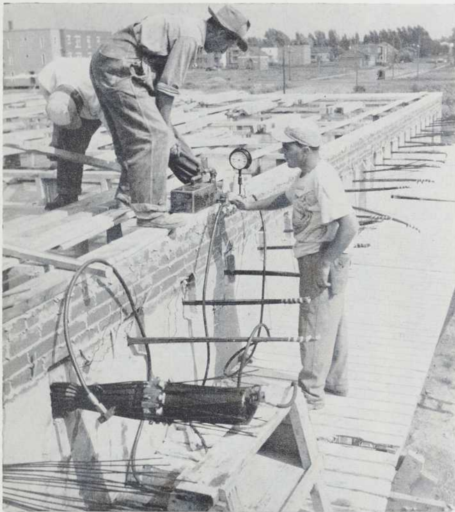
Fig. 6 — Application de la précontrainte sur le chantier. Les ouvriers n'ont nul besoin d'un long entraînement, il suffit de surveiller la tension exacte. On remarque le vérin au premier plan tandis que les ouvriers gardent l'œil sur la pression indiquée au cadran.
