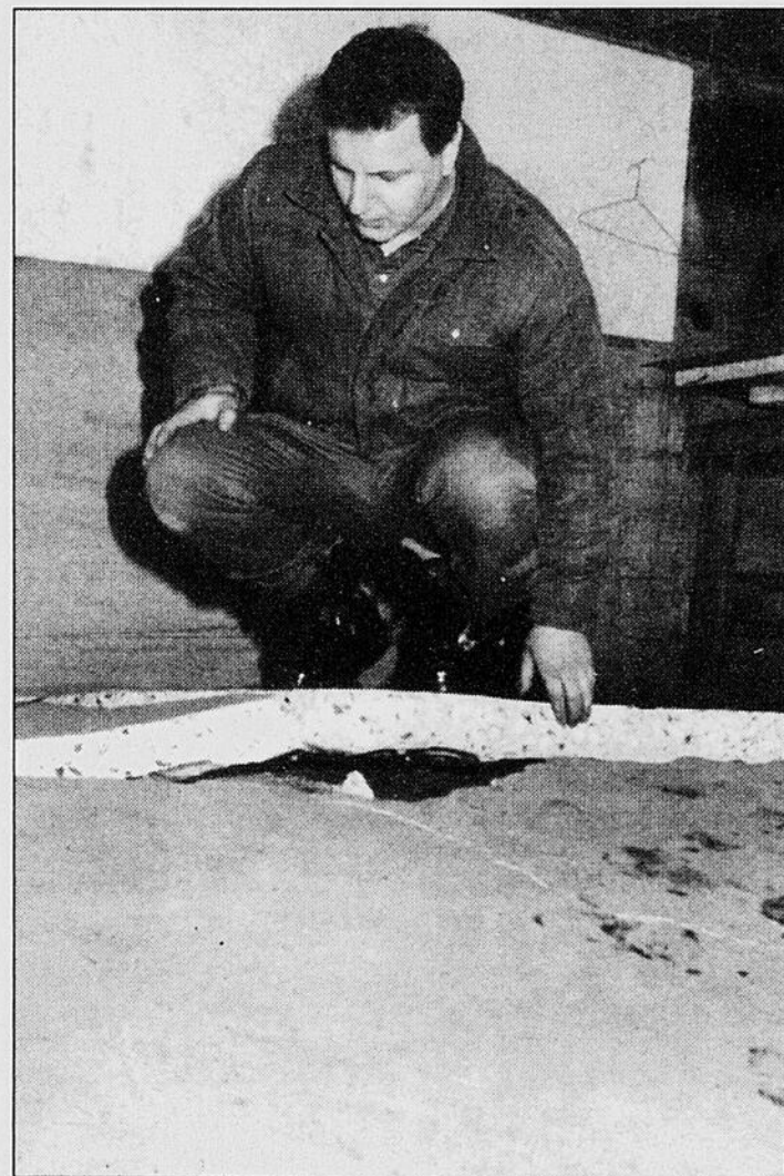
PLANCHER - Denis Laberge constate l'effet du tremblement de terre dans un logement HLM situé sur la rue Hervé Tremblay à La Baie.
