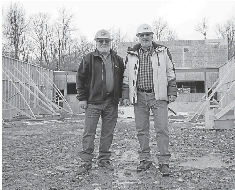
Roger Smith, à droite sur la photo, est accompagné de Mike Duern sur le chantier du nouveau centre de curling des Collines. — SIMON SÉGUIN-BERTRAND, LE DROIT
