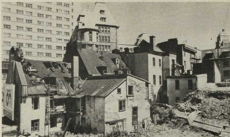
Parfois la pollution des espaces est créée par la négligence: maisons historiques négligées au point de tomber en ruine en plein centre de la ville de Québec; elles appartiennent à un des grands établissements de la ville.
