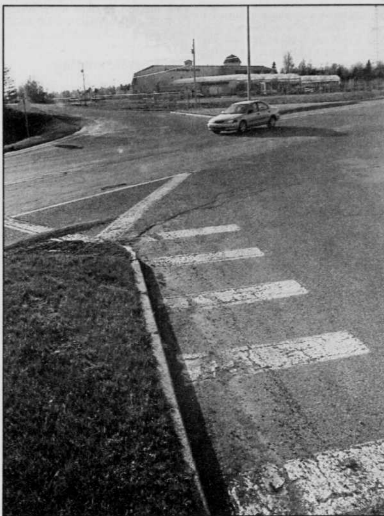
En mars, le directeur des services techniques, Serge Robert, avait présenté un rapport au conseil pour l'avertir que le traitement du dossier du lien routier s'annonçait beaucoup plus long que prévu.
