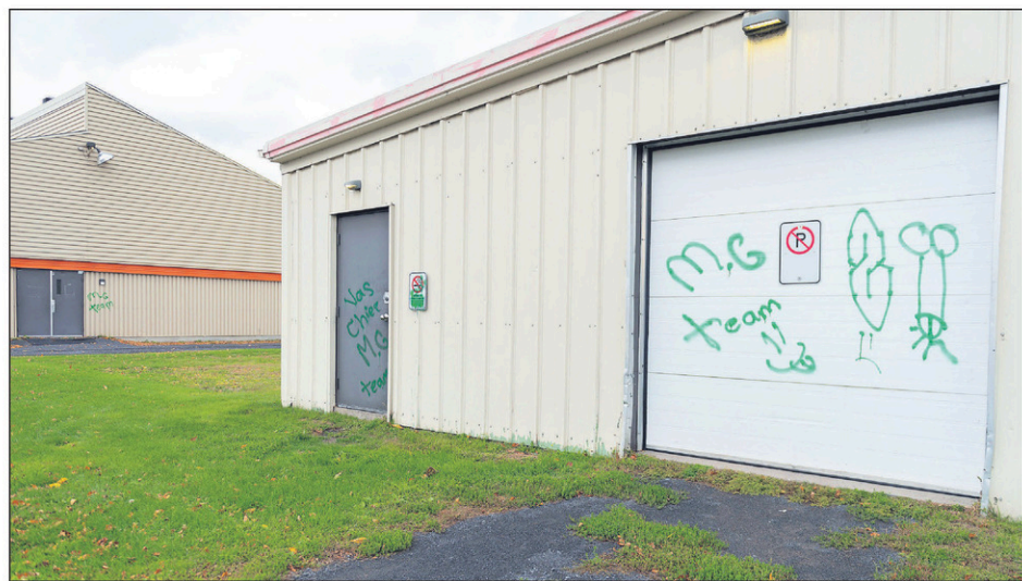
Les policiers ont ouvert une enquête dans le but d'identifier les graffiteurs qui ont laissé leurs traces sur les nouvelles installations.
