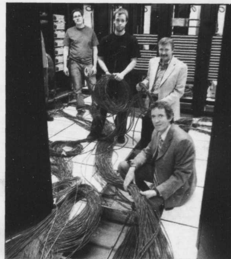
Des équipes de techniciens travaillent présentement à installer plus de 200 000 pieds de câble audio et vidéo à l'intérieur du «cerveau» du Pavillon. Il s'agit de la salle de contrôle technique. Sur la vignette, les techniciens sont accompagnés de Michel Bouchard et du directeur du cégep, Gilbert Grenon.
