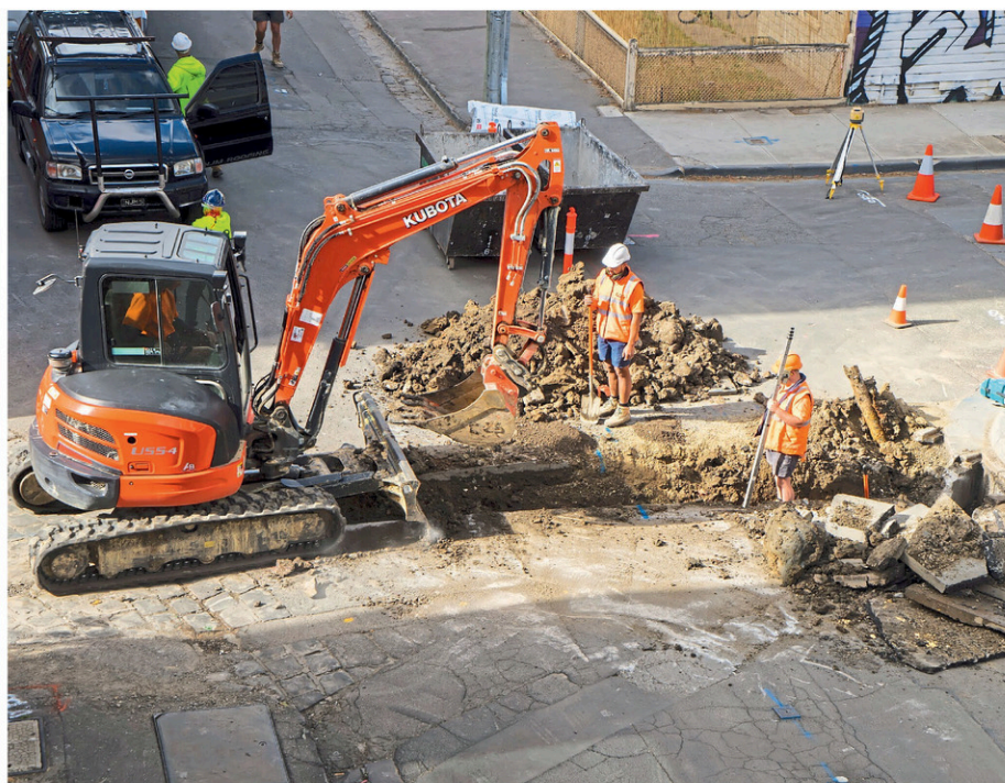
En 2024, l'Estrie a terminé au 3 e rang pour le plus grand nombre de bris d'infrastructures sur les 756 incidents signalés à l'échelle du Québec, selon Info-Excavation. (Photo: gracieuseté - Info-Excavation)
