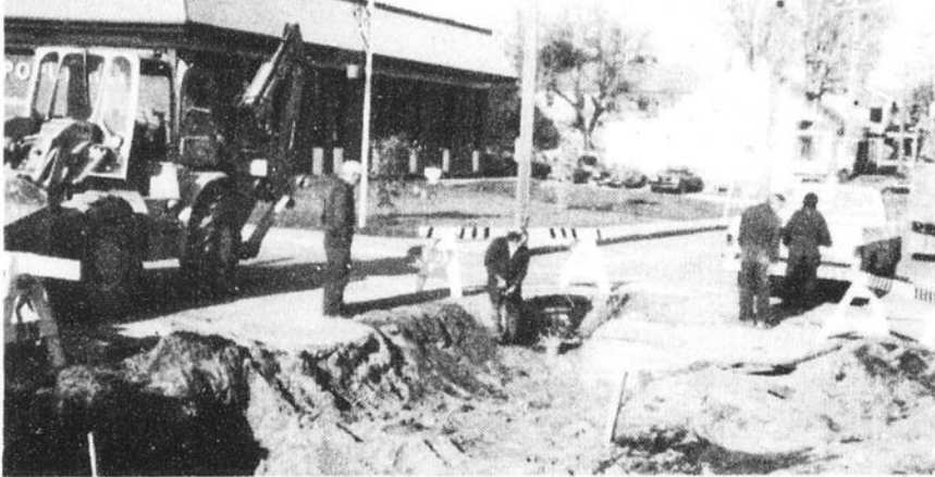
Les employés de ville Saint-Gabriel effectuaient des travaux, cette semaine, pour donner les égouts et l'aqueduc au Centre sportif et culturel. On sait que le conseil a donné un octroi de $8,000 pour ces travaux.
