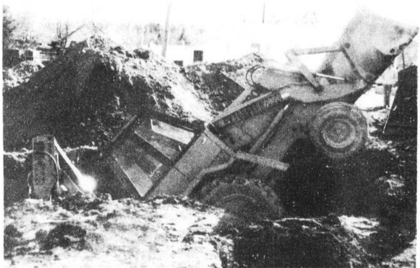
Une pelle mécanique, qui travaillait sur le chantier du Centre sportif et culturel, s'est retrouvée dans le trou, la semaine dernière, lorsque la terre a cédé. Une autre pelle est venue à sa rescousse. Le conducteur a avoué avoir eu la frousse.
