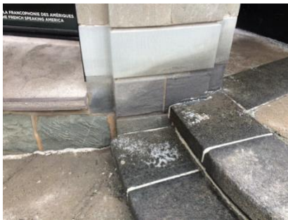
Remontées capillaires (sel)
