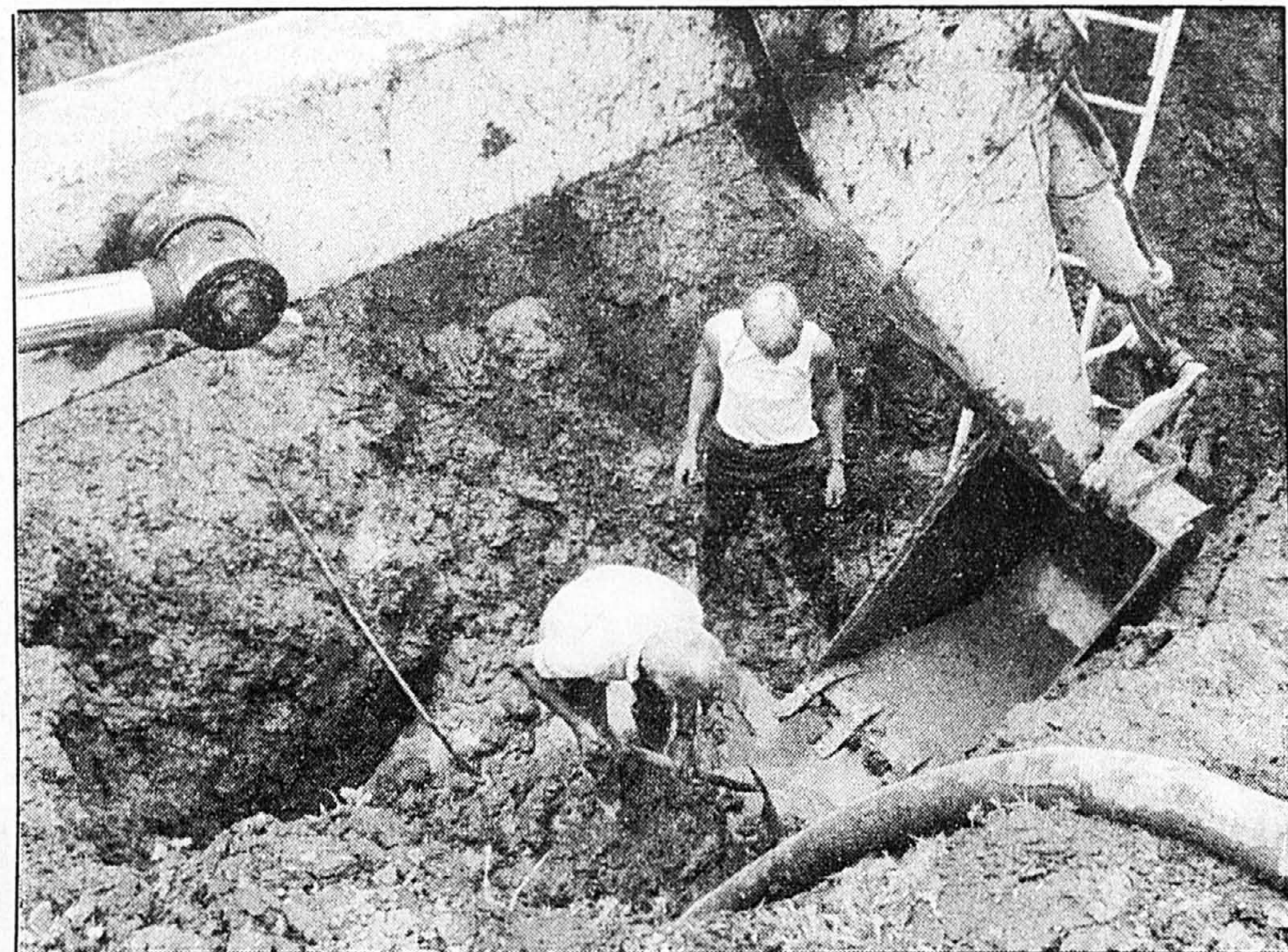
Ayant repéré l'endroit précis où un tuyau de 24 pouces de diamètre s'était brisé pour priver d'eau potable la presque totalité de Saint-Lambert et une partie de la ville voisine de Lemoine, les ouvriers ont dû creuser jusqu'à dix pieds de profondeur pour atteindre le conduit. photo Réal St-Jean, LA PRESSE
