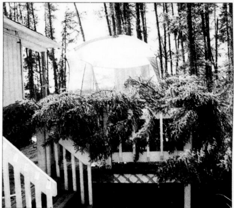
Généralement, les contrats d'assurances couvrent les dommages causés par le vent.
