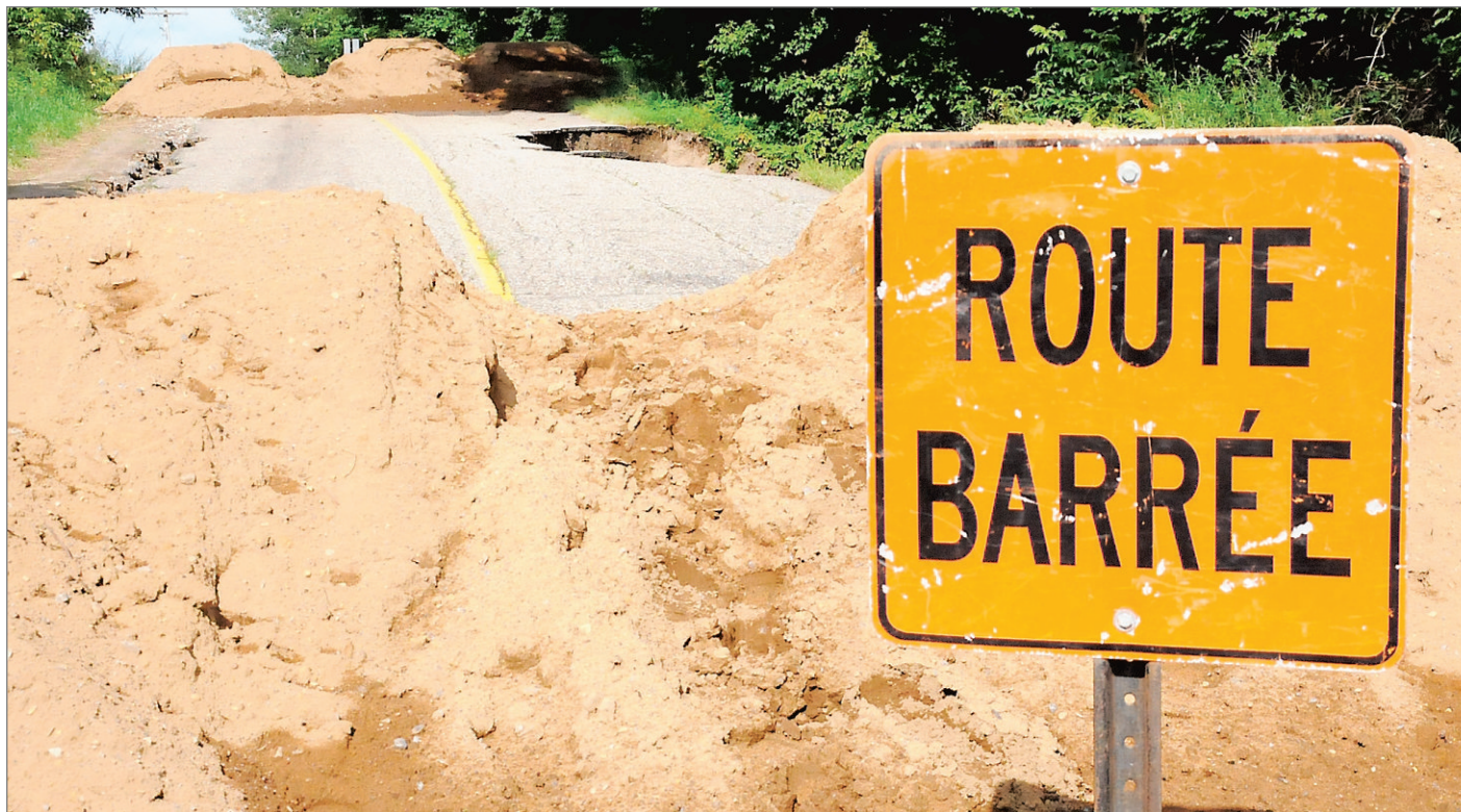
Le glissement de terrain a carrément bloqué la circulation du 3e Rang Brandon. PHOTO CAROLINE MURRAY-DAIGNAULT
