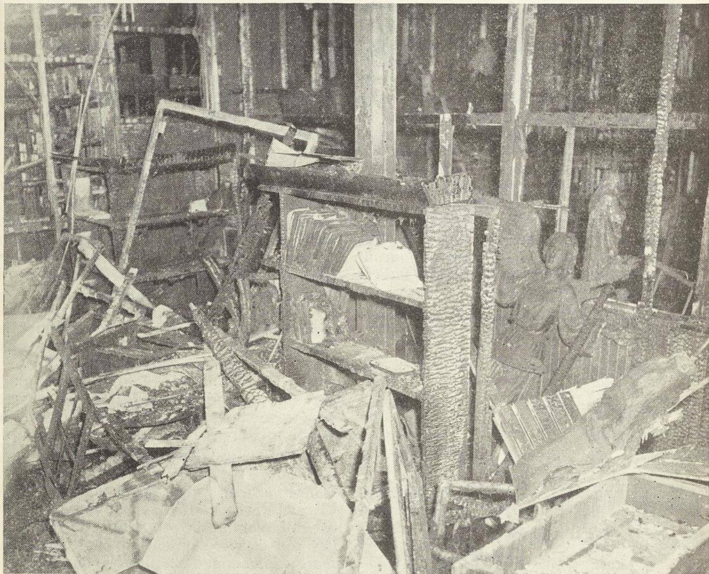
Etat de l'ensemble présenté sur la couverture après l'incendie de l'Ecole du Meuble.
