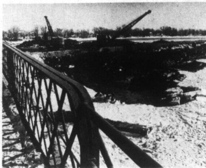
La construction de portes de sécurité dans le canal permettront d'éviter que l'eau passe au-dessus de la bande du canal lors des crues printanières. Les travaux seront terminés en avril. (Photo Ken Wallett)
