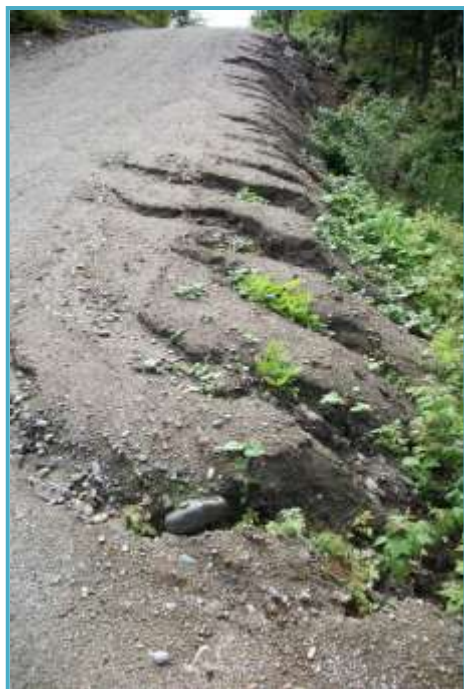
Photo 12 : Érosion, chemin des Berges, lac Nick
