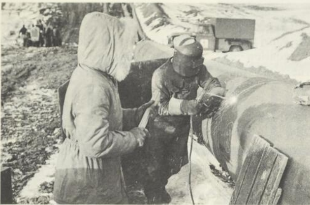
Les sections d'acier sont enfouies à six pieds sous terre et soudées bout à bout sur place.
