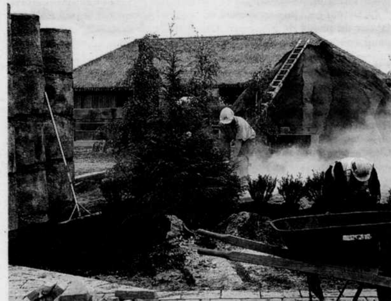
Les ouvriers s'affairaient aux derniers préparatifs, hier, en vue de l'ouverture officielle du site prévue pour demain.
