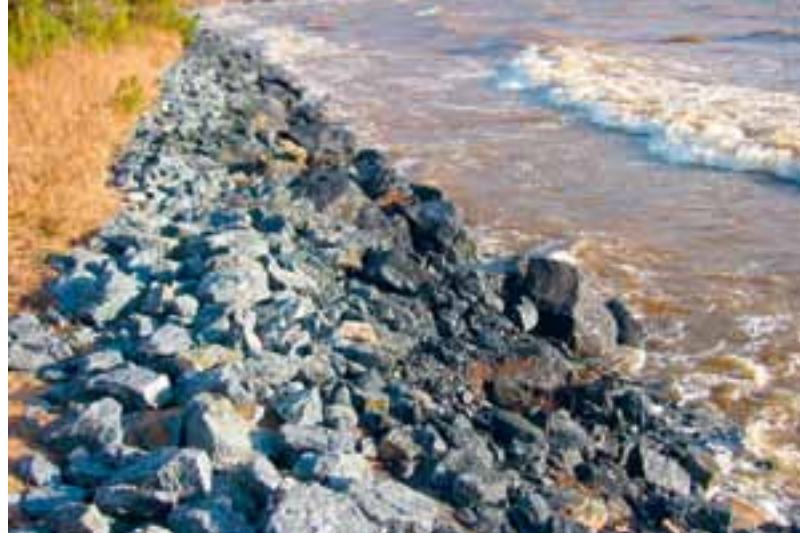
Figure 1. Perré (enrochement) aménagé sur la berge du parc national de la Pointe-Taillon
