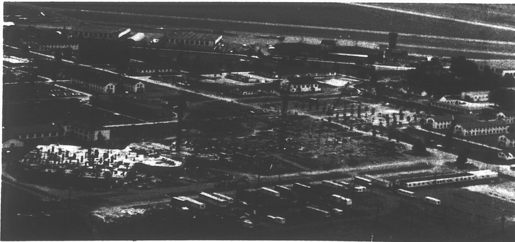
Cette vue aérienne du chantier de la base donne une idée précise de la forme de l'édifice appelé "mégastructure" et aussi de sa longueur.
