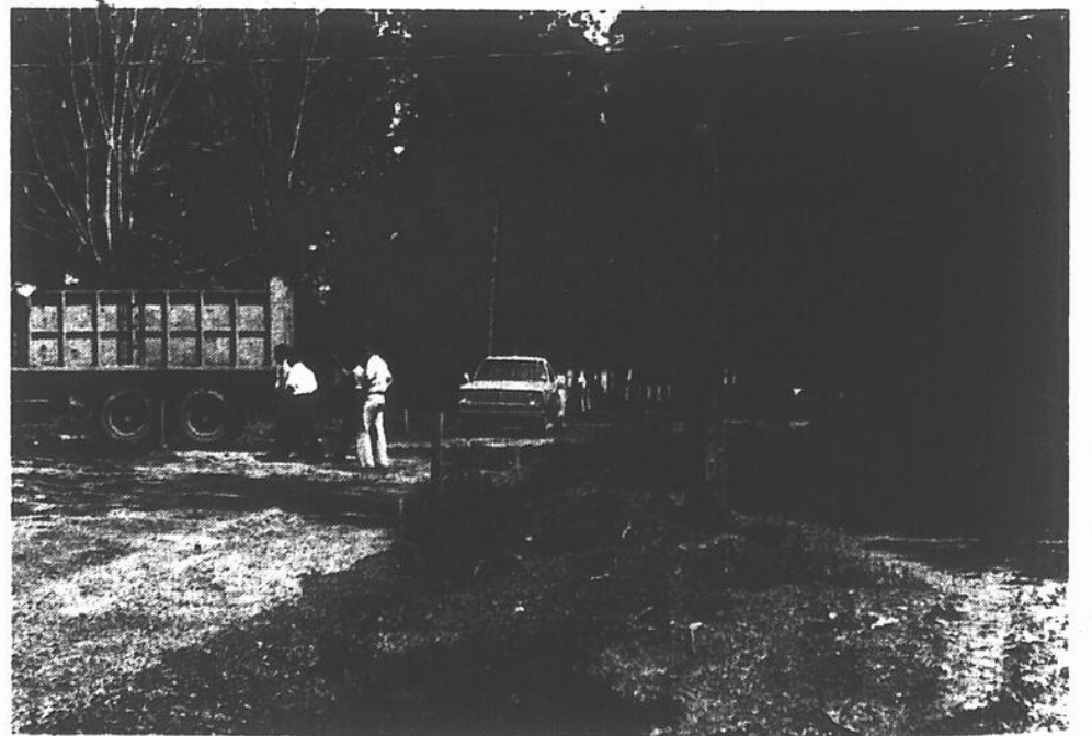
Les travaux d'aménagement au Parc Municipal doivent être terminés cette semaine si le soleil collabore.
