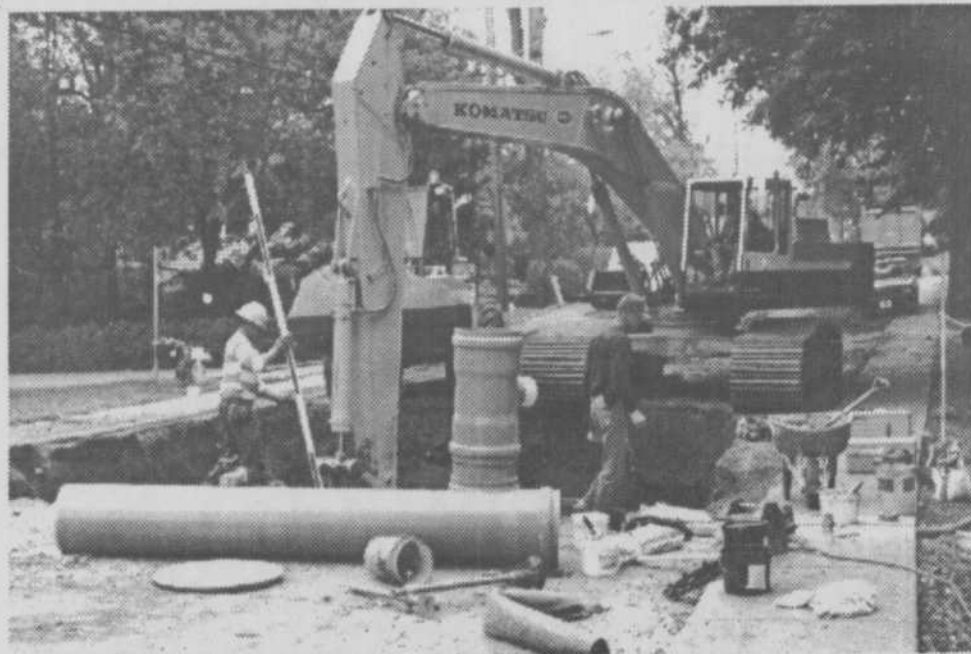
Cet automne et le printemps prochain, la Ville de Terrebonne procèdera aux derniers grands travaux d'assainissement des eaux sur toute la longueur de la rue Masson. (photo: Gilles Bordonado)
