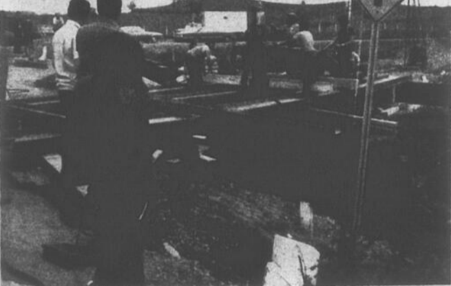
Suite aux forages préliminaires à la construction d'un pont à Lac-Drolet, une importante source sous-terraine a jailli; 1,000,000 gallons d'eau se déversent par jour; la source menace d'affaiblir les terrains avoisinants.
