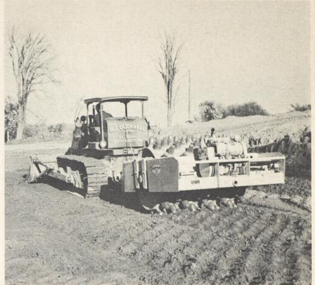
Sur les remblais où le matériau possède une haute teneur d'humidité, on emploie un rouleau vibreur à "pieds de moutons". Cette méthode s'est avérée économique et efficace en particulier pour le remblayage des zones profondes. Ce rouleau Vibro-Plus, de 76 pouces de largeur, est remorqué par un tracteur International TD 15.
