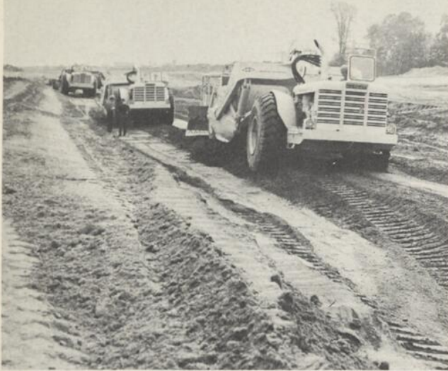
Trois décapeuses Allis-Chalmers TS 360, à l'oeuvre sur la première section de l'autoroute des Laurentides. Les trois unités réunies sont capables de porter approximativement 60 verges cubes.
