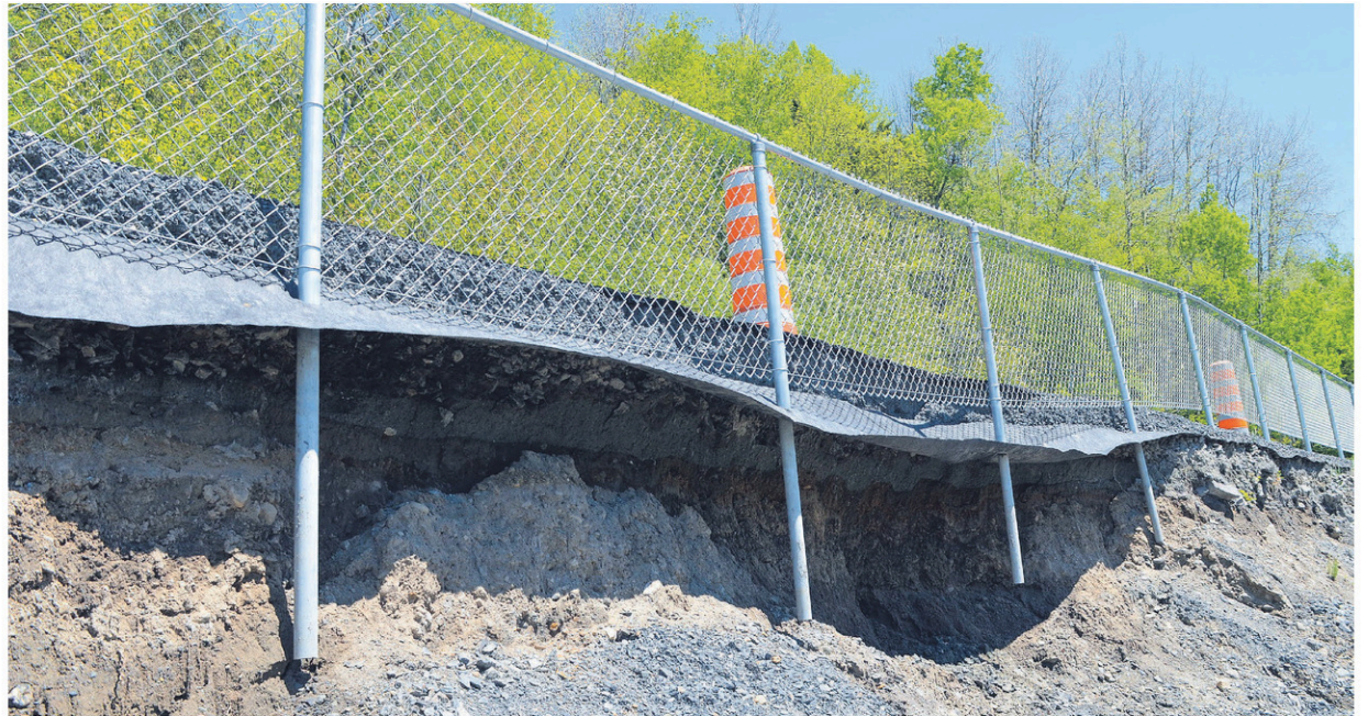
Vu de la rivière, l'affaissement est plus important qu'il n'y paraît. Les poteaux de la clôture ne touchent même plus le sol. (Photo L'Éclaireur Progrès – Frédéric Desjardins)
