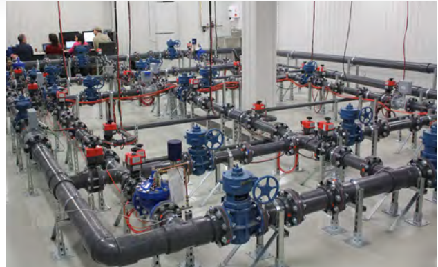
Réseau de distribution d'eau potable du laboratoire
